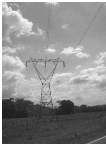
Figura 30. Torre de 400 kV, de la empresa EDELCA
